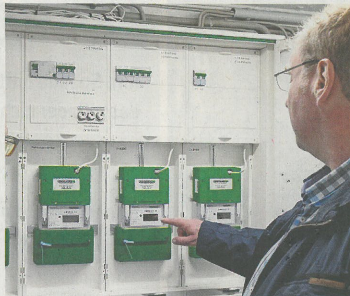
Intelligente Stromzähler der Firma Discovery. Die Messgeräte müssen hohe Sicherheitsstandards erfüllen.
